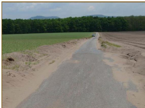
Obr. 5-4: Zavátí komunikace u Nového Přerova (foto: SPÚ Břeclav, jaro 2009)
