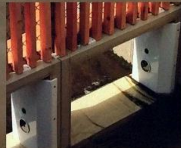
Obr. 2: umístění monitorovacích systémů v hlavním rybím přechodu
